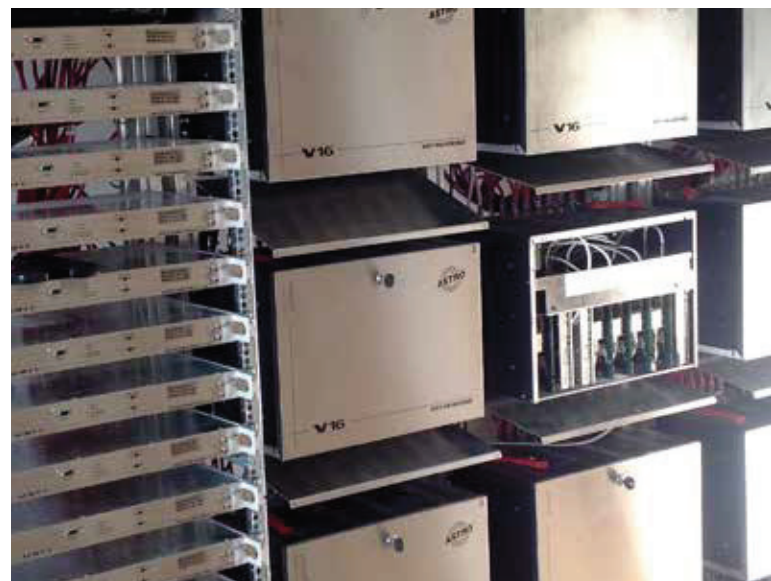
Blick in unsere Kabelkopfstelle in Wilhelmshaven
